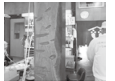
【丁子屋さんに残る柱の傷】明治9年5月から新政府に委託された郵便事業をしていたため、暴動で打ち壊しに遭った建物に残ったナタの痕跡 参考史料:治田村誌 他
